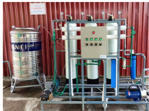
Hình 5. Hệ thống khử mặn công suất 200 L/h
