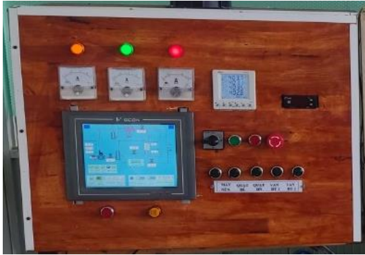
Hình 2. Bố trí thiết bị bên ngoài tủ điện
