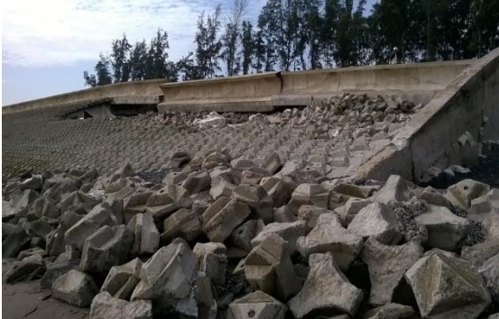
Hình 1: Hiện trường sụp lún kè Xã Hiệp Thành, huyện Duyên Hải, tỉnh Trà Vinh tháng 12/2014
