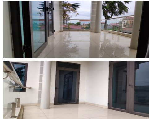
Hình 2. Hiện trạng thực tế ban công
